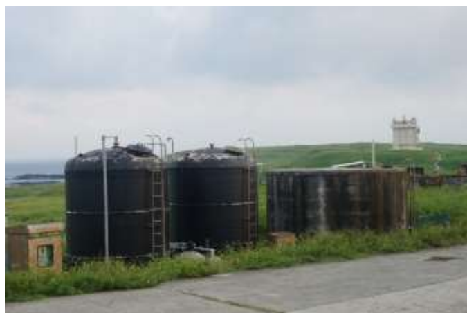
照片 4-1-10：東吉嶼深水井及蓄水塔
