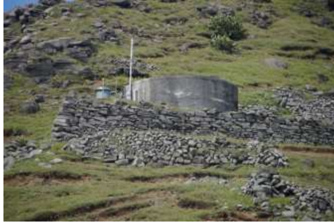
照片 4-1-11：東嶼坪嶼深水井及蓄水塔
